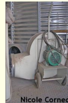
Ventilateur d'un silo à céréales
